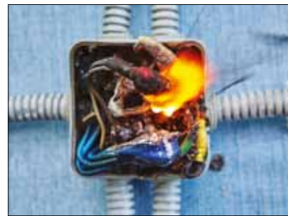
Рис. 5. Искрение в результате нарушения электрического контакта не может быть распознано обычным защитным автоматом, тем не менее оно способно привести к пожару
